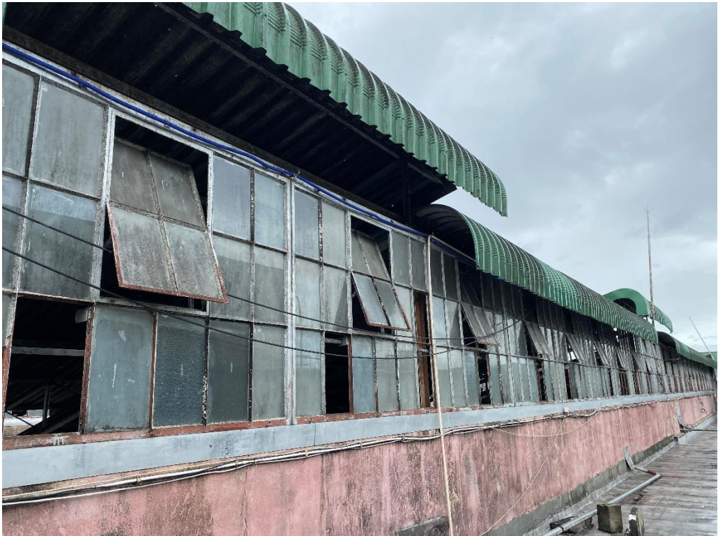
28. Pack Hall: broken windows
